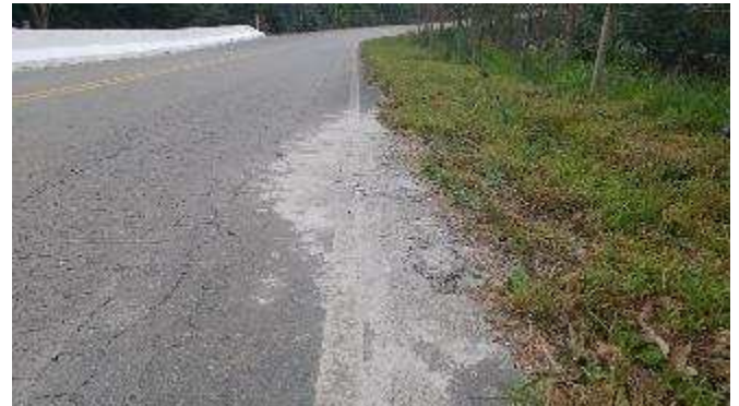
Figura 30: Marcas de cimento na pista km 31
