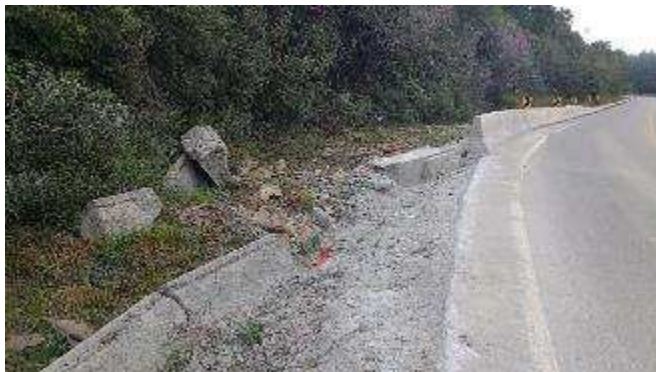
Figura 33: Proteções de pista quebradas km 34
