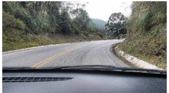
Figura 62: Sinais de frenagem
