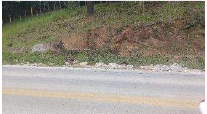
Figura 77: Sinais de perda de carga
