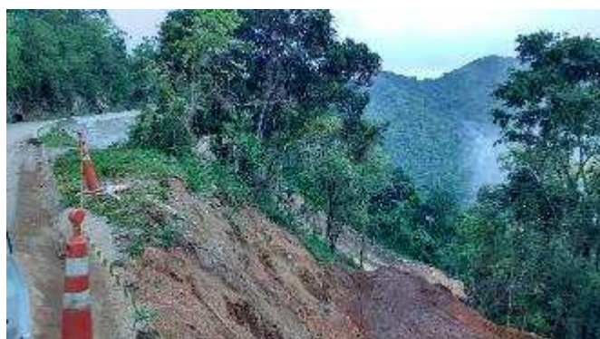
Figura 08: Encostas abaixo da pista
